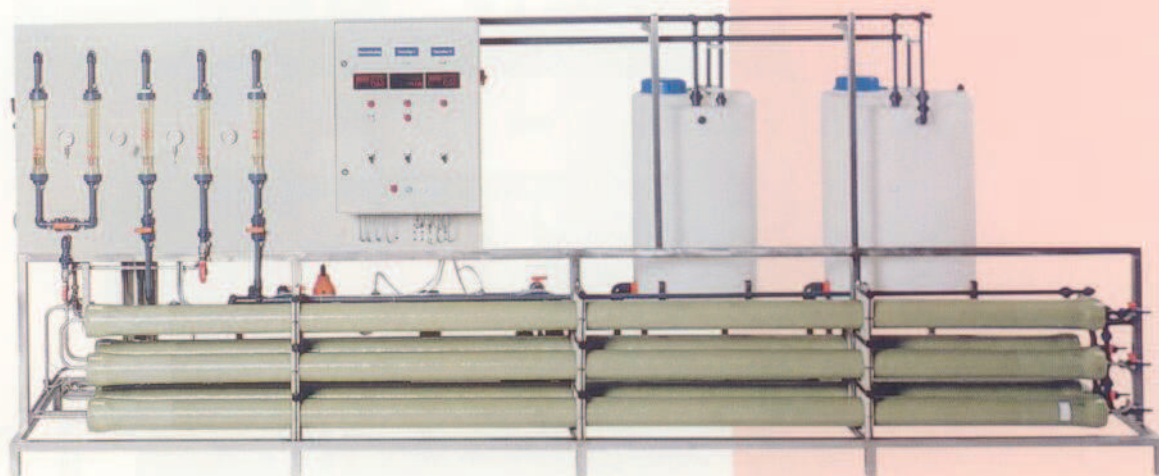
RO Unit 20m 3 /h
